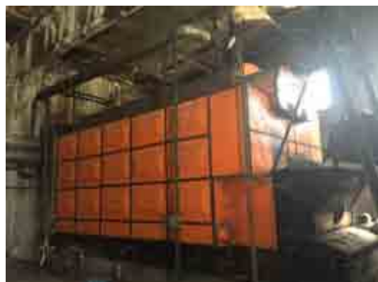
现有工程 4.2MW 燃煤热水锅炉
